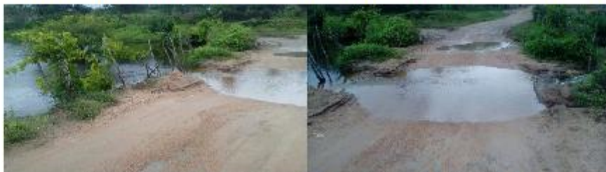
Situação da estrada que dá acesso à Vila do Xique-Xique. (Imagem obtida em 07 de agosto de 2017)
