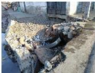
Calçamento destruído localizado na 2ª Trav. Antônio Martins – Vassoural (Imagem obtida em out/2017 – acervo próprio)
