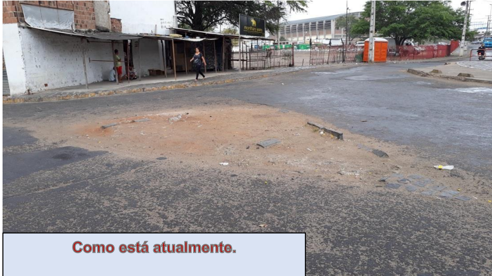
Situação precária da rotatória localizada entre as ruas Luís Paes e João Euzébio Ferreira – B. Nossa Senhora das Graças (acervo próprio).
