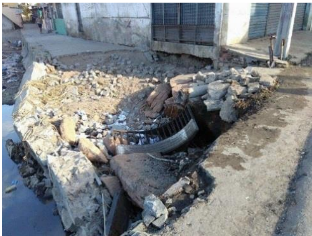
Calçadão destruído localizado na 2ª Trav. Antônio Martins – B. Vassoural.
