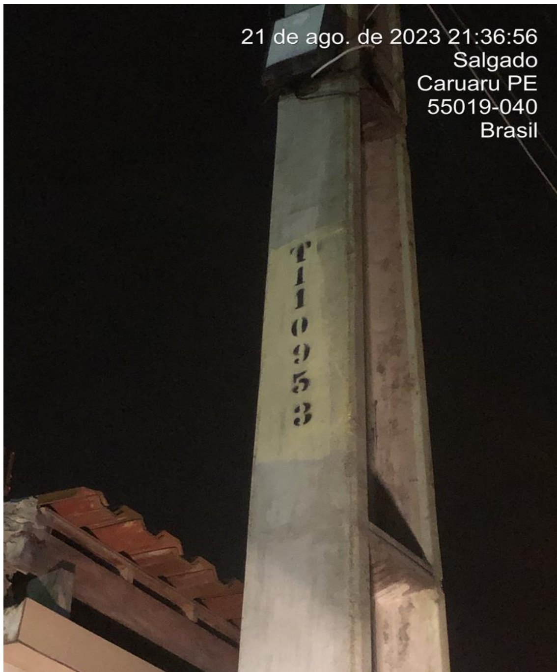
Rua Maria de Lourdes (iluminação pública T 110953)
